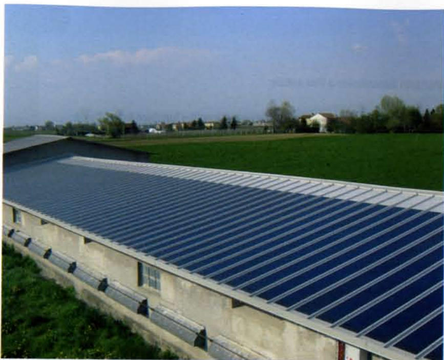
LA SUPERFICIE OCCUPATA DAL PANNELLO COIBENTATO A FILM SOTTILE SUL CAPANNONE DELLA SCALCHI CARLO È PARI A 540 M 2 , MENTRE LA PENDENZA DELLE FALDE È DI CIRCA 10 GRADI. L'IMPIANTO HA UNA POTENZA DI 32 KW
